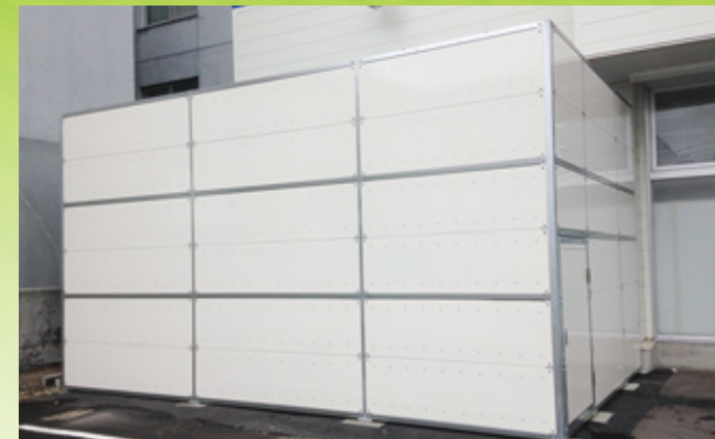
札幌某所 室外機用遮音壁
