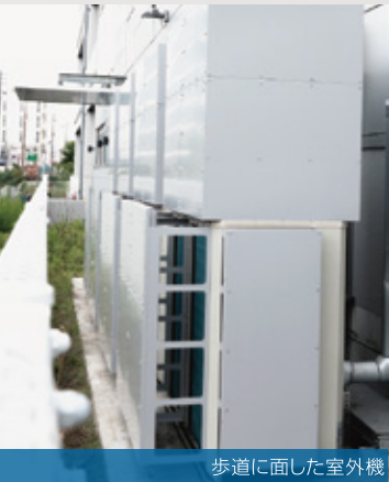
歩道に面した室外機
